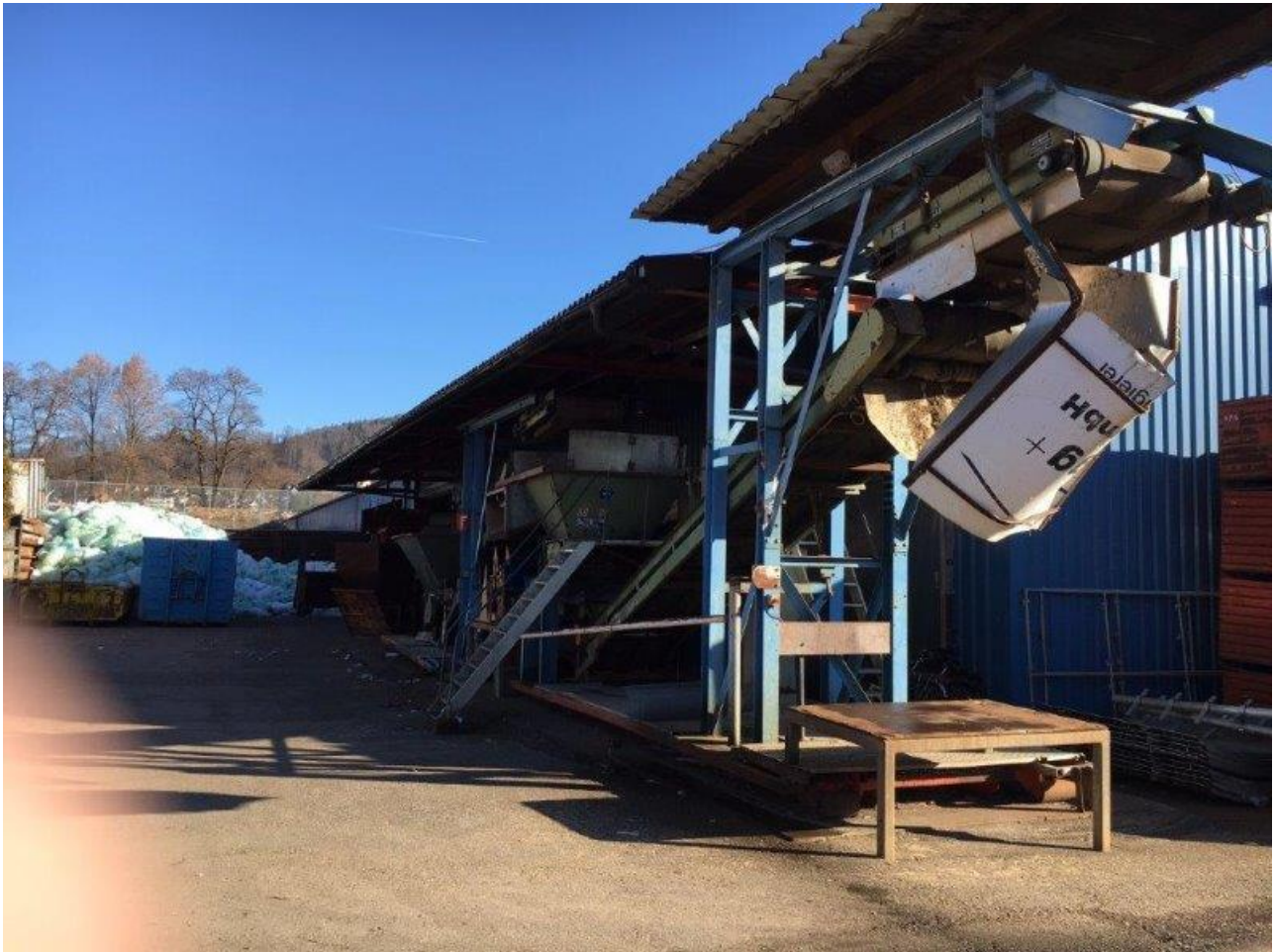
Bilder der installierten Anlage
